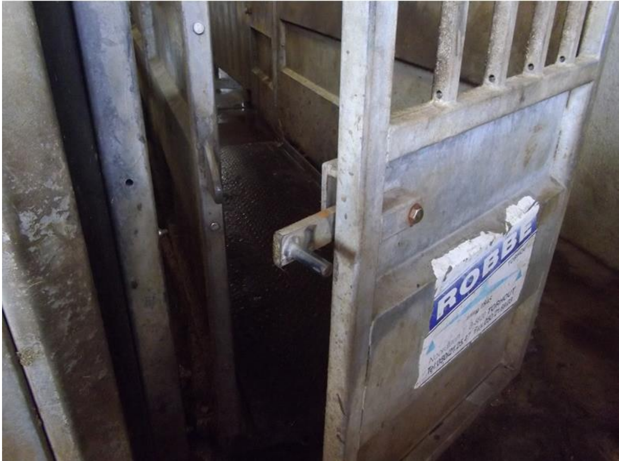
Figuur 1: het sluiten van de poort van de weegschaal veroorzaakt veel lawaai ten gevolge van een metaal op metaal-contact t.h.v. de grendel.
